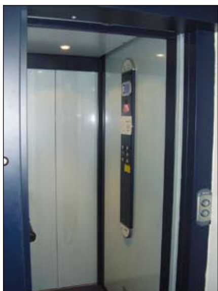
Grazie al nuovo ascensore l'accesso alla biblioteca è più facile per le persone con difficoltà motorie
