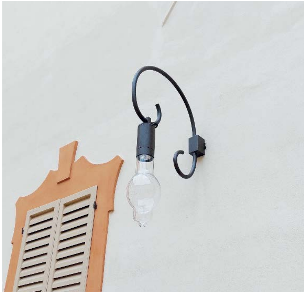
Foto: uno dei nuovi punti luce installati
