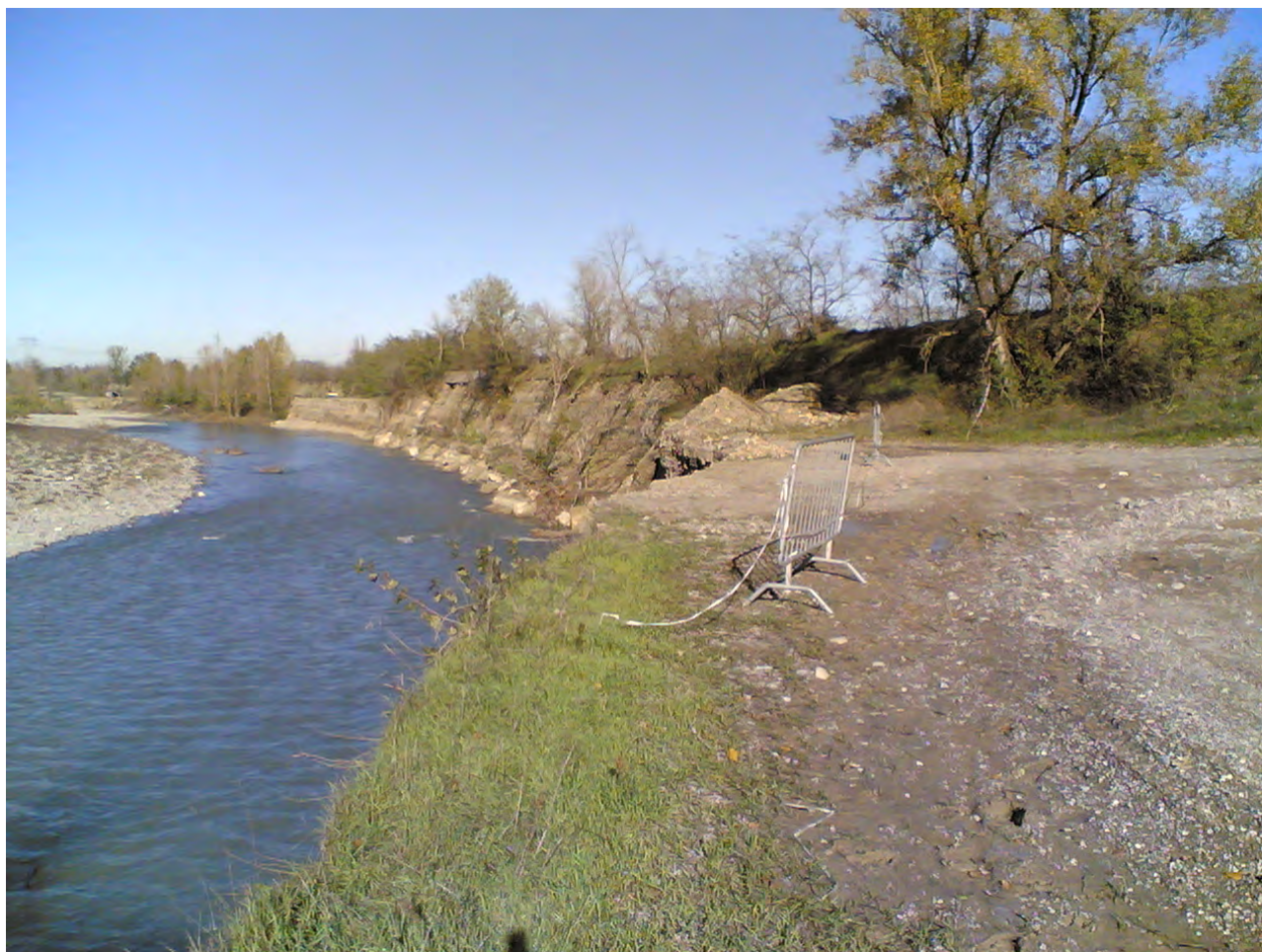
FOTO 3: Veduta della strada Demaniale esistente erosa dal Fiume Panaro.
