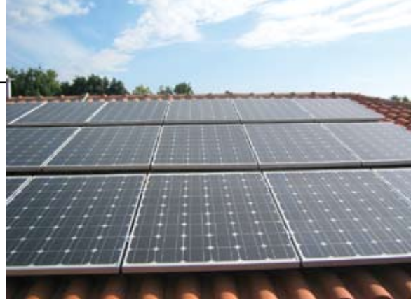
I pannelli solari sul tetto delle materne Sighicelli
